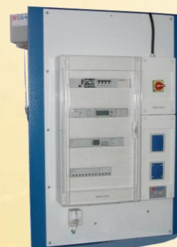
Face armoire de commande
