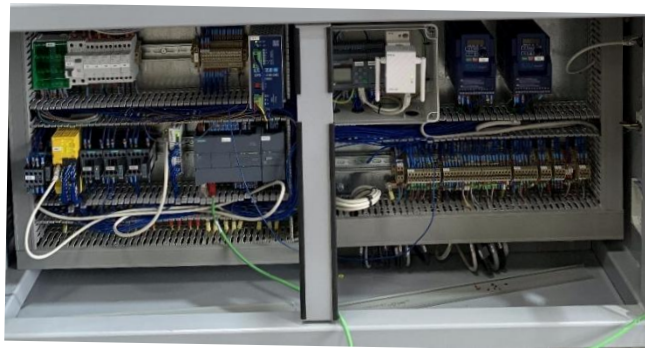
Vue de l'armoire électrique
