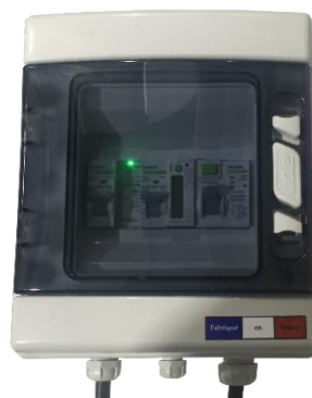
Coffret de protection et de connexions des panneaux
