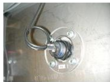
Capteur "Niveau cuve produit liquide"
