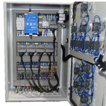
Coffret électrique avec borniers de raccordement classiques et enfichables
