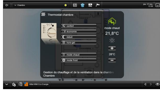
Ecran de commande du thermostat de la chambre
