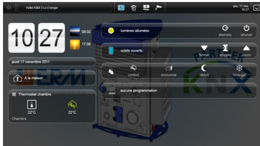
Ecran d'accueil indiquant l'état du store électrique et la température de la chambre
